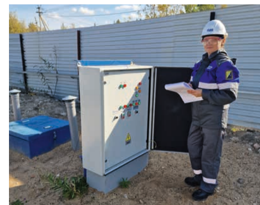
Планный осмотр режима работы канализационной насосной станции
